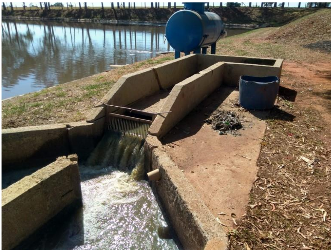
Figura 36: Tratamento preliminar na ETE
